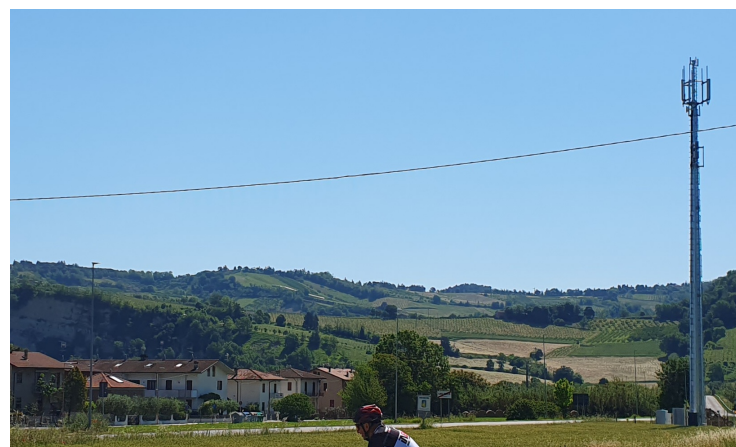
La nuova antenna telefonica
